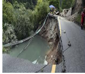
glissement de terrain
