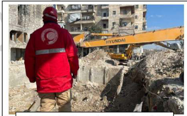
عملية الإسعاف بعد انهيار مبنى في حلب بسوريا
